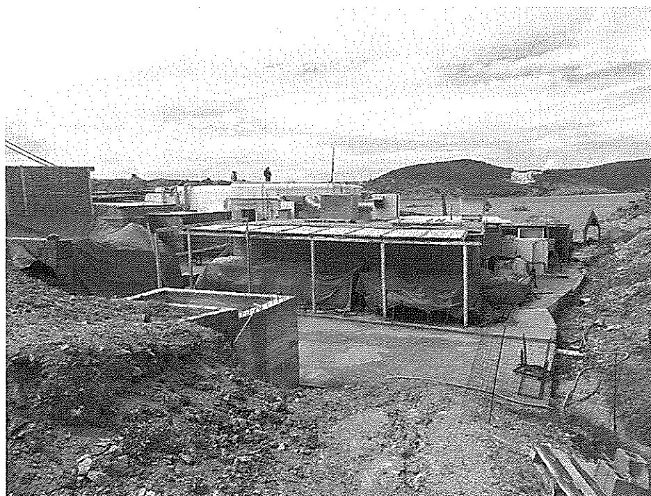
Αυθαίρετη κατασκευές με αρ. (14), (11), (10), (12), (13) και (9)
