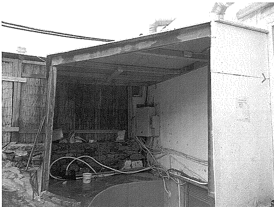
Αυθαιρετη κατασκευή με αρ. (7)
