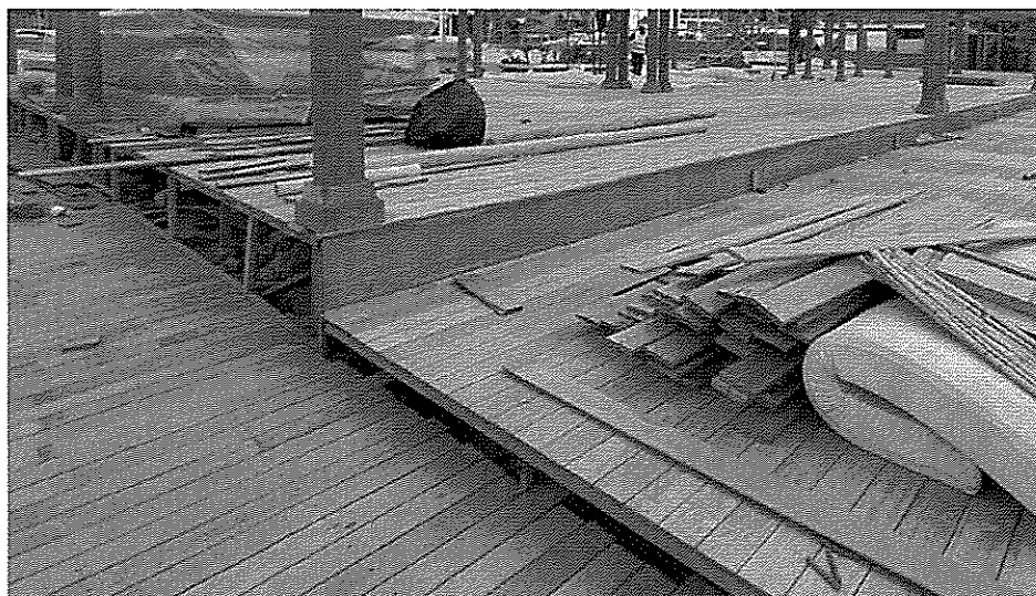
Αυθαίρετη κατασκευή με αρ. (3)
