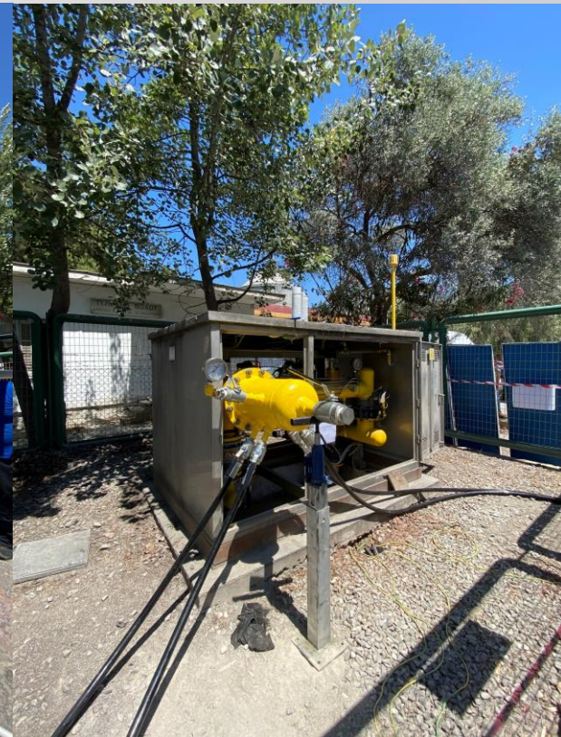
Τροφοδότηση στο φίλτρο εισόδου του Σταθμού Διανομής IRI ΑΓΕΤ
